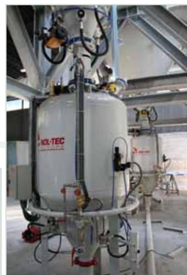
Batería de emisores en vidriería
